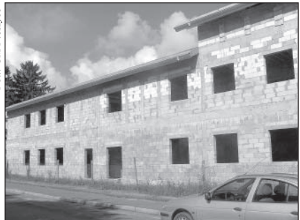
Brak prowadzonych prac na placu budowy przychodni nie oznacza, że w sprawie budowy nic się nie dzieje. Trwają formalności związane ze złożeniem dodatkowej dokumentacji, podpisaniem umowy na dofinansowanie i ogłoszeniem przetargów
